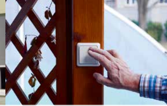
Bahçede kablosuz devreleme
